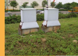
變電箱旁的蟻丘
